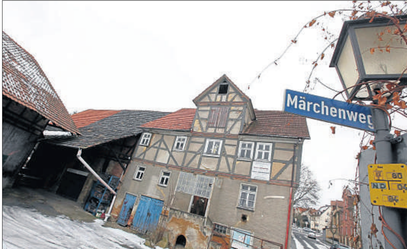
Streitobjekt: Die Hofanlage aus dem späten 19. Jahrhundert im Niederzwehrener Märchenviertel ist stark sanierungsbedürftig. Wegen der hohen Kosten wollen die Eigentümer die Gebäude abreißen. Fotos: Fischer
